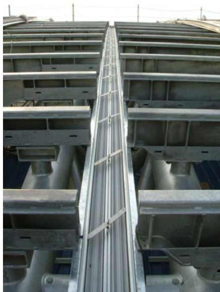
高鐵烏日站 外牆圓弧形伸縮縫
